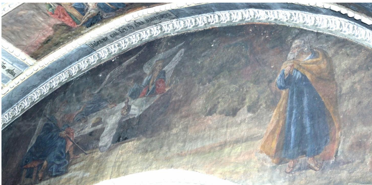
Іл. 5. Південна стіна трансепту Троїцького собору з композицією «Старозавітна Трійця». Сучасний стан. Фото Т. Сердюк
